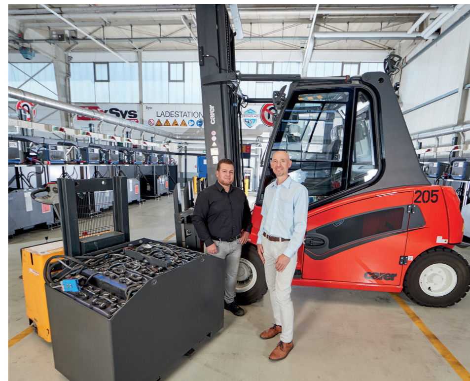
Heino Hövelmann (r.) mit dem Leiter Gesamtlogistik Michael Michailidis bei der Vorstellung der neuen Batterieladestation
