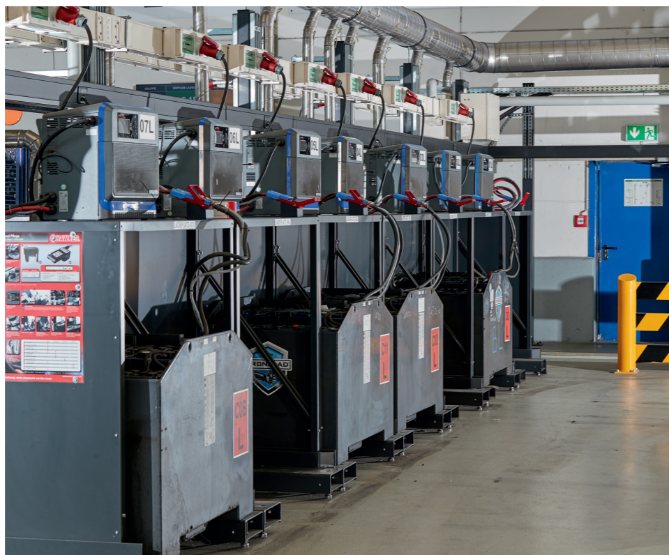
Teilbereich der leistungsfähigen Batterieladestation
