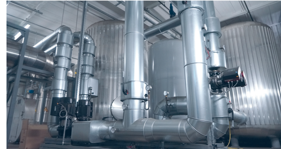
Betriebseigenes BHKW – seit 2016 im Einsatz, Ende 2020 folgt das zweite
